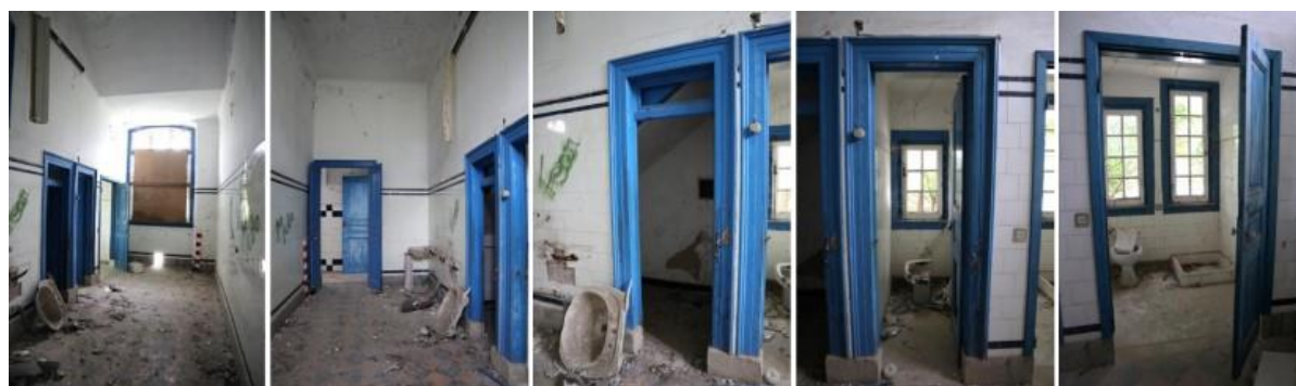
Figura 27 - Instalações sanitárias piso 0. Fonte: Relatório final de curso de Arqueologia, estudante Leonor Medeiros, Faculdade de Ciências Sociais e Humanas, Universidade Nova de Lisboa.
