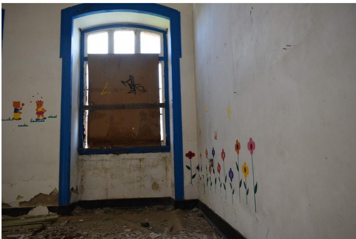
Figura 41- Algumas patologias no piso 1. Fonte: Médio Tejo.
