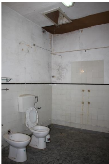
Figura 32 – Casa de banho principal, piso 1; ano 2021; Fonte: Ana Ferreira
