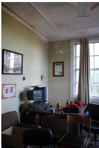
Figura 28 – Sala 4, situada na fachada Norte; ano 2021; Fonte: Ana Ferreira
