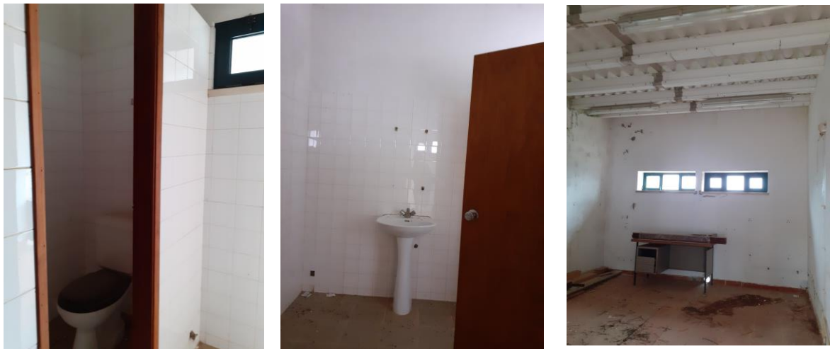
Figura 37, 38 e 39 - Balneários e zona de arrumação. Estando estes espaços no edifício mais pequeno, a vandalização piorou. Foram arrancados espelhos, torneiras, materiais cerâmicos das casas de banho e na zona de arrumos foi tudo destruído e deixado com janelas partidas e porta aberta. Fonte: Autor.
