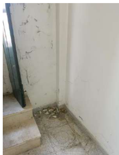
Figura 99 - Vestígios de patologias de sujidade encontrados nas paredes do edifício
