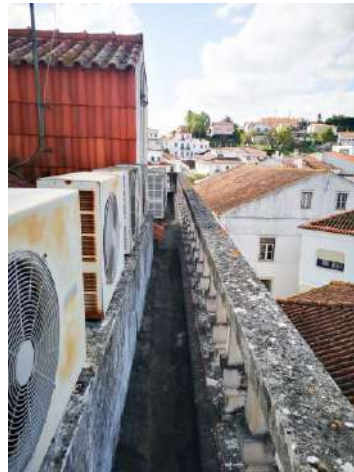
Figura 57 - Batalha, Edifício Mouzinho de Albuquerque, 3º piso, vista do exterior
