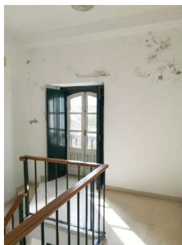
Figura 97 - Vestígios de humidade encontrados nas paredes do edifício
