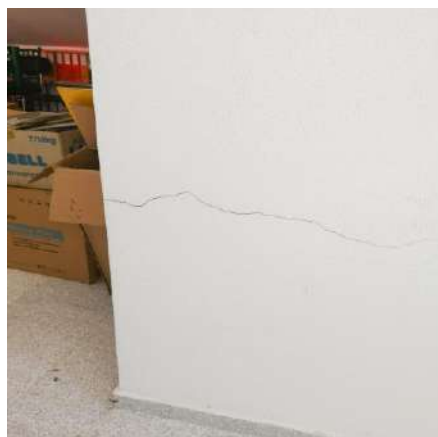
Figura 98 - Vestígios de patologias de fissuração encontrados nas paredes do edifício
