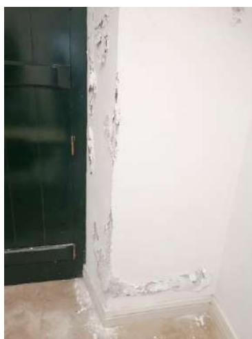
Figura 96 - Vestígios de humidade encontrados nas paredes do edifício
