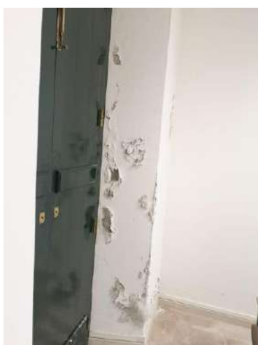
Figura 95 - Vestígios de humidade encontrados nas paredes no edifício
