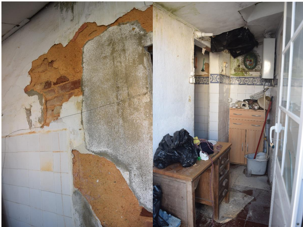
Figura 19 Fotografias dos danos nos acrescentos
