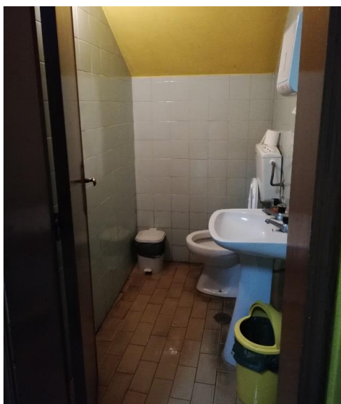
Figura 12- Instalação sanitária. Fonte: Ana Mota
