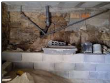
Figura 29 - Tubos de esgoto
