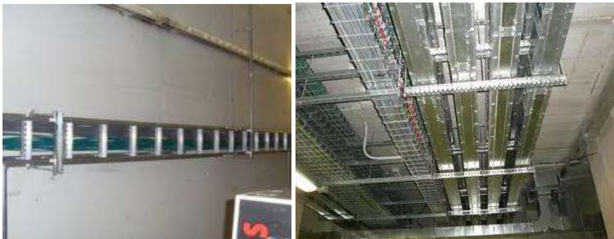
Figura 22 - Tubulações na parede visível. Figura 21 - Tubulações em teto à vista. Fonte: cableado estruturado sasei, 2026
