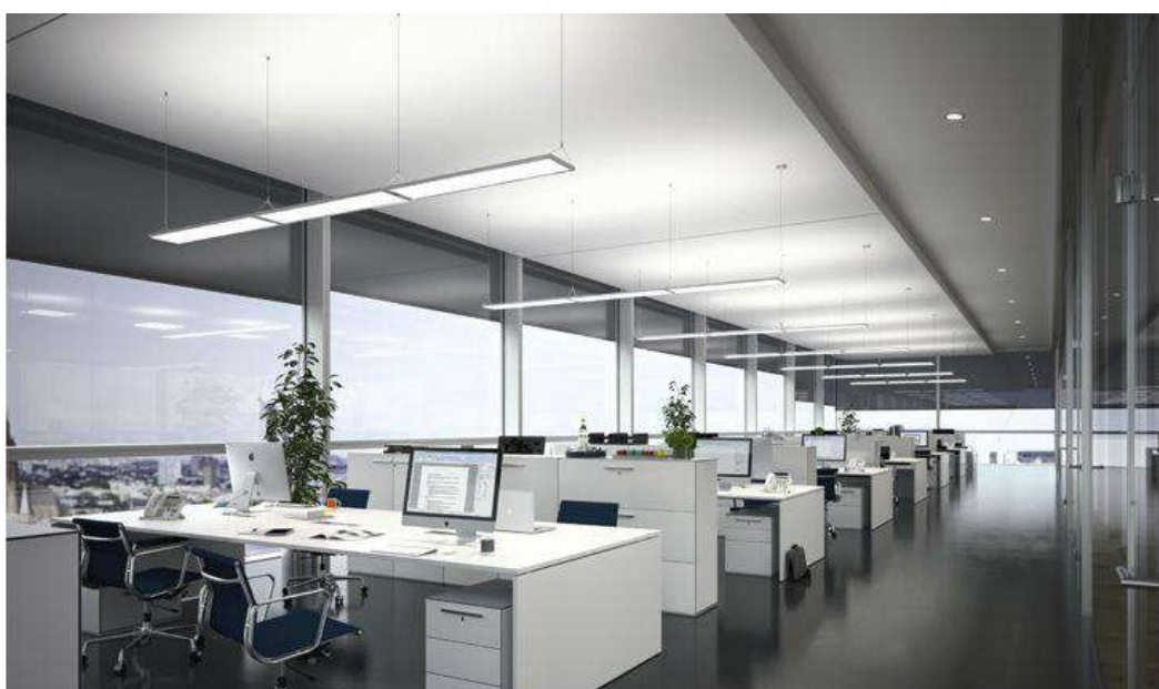
Figura 31 - iluminação artificial em ambiente de escritório. Fonte: Wattlamp, 2026
