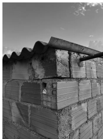
Figura 160 - Parede com fissura - Fachada posterior da habitação 1. Fonte: Adriana Tomás.
