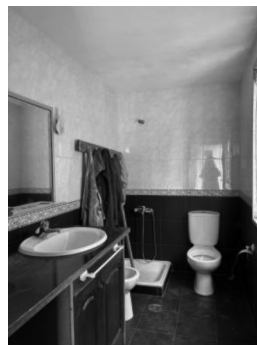
Figura 54 - Instalação sanitária. Fonte: Adriana Tomás.
