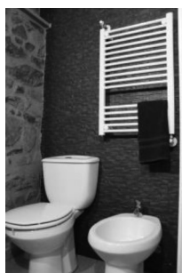
Figura 33 - Instalação sanitária. Fonte: Adriana Tomás.
