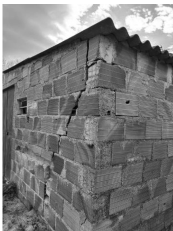
Figura 159 - Parede com fissura - Fachada da habitação 1. Fonte: Adriana Tomás.
