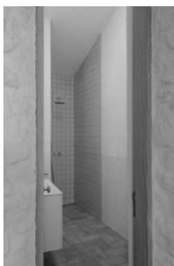
Figura 65 - Instalação sanitária. Fonte: do mal o menos.
