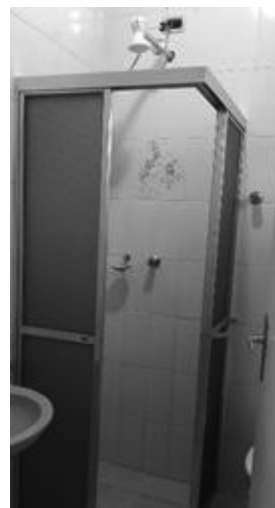
Figura 124- Instalação sanitária da suíte. Fonte: Imagem autoral (2024)
