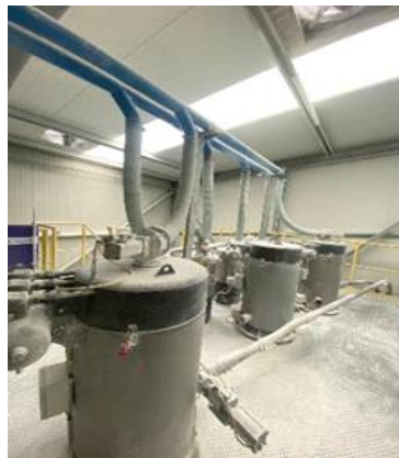
Figura 21 - Central de cones
