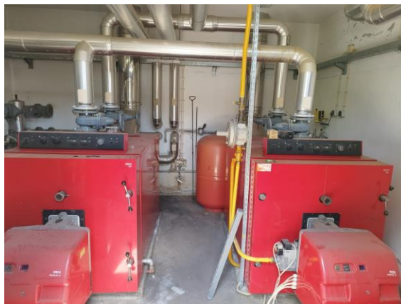
Figura 52: Caldeiras que produzem água quente para o Bloco C e Bloco D.
