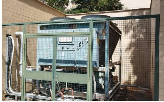
Figura 51: Chiller que produz água refrigerada para o Bloco C e Bloco D.
