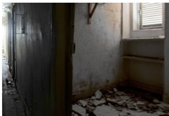
Figura 23 - Patologia no pavimento Fonte: RUIN'ART
