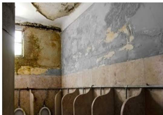
Figura 21 - Patologia nas paredes interiores Fonte: RUIN'ART
