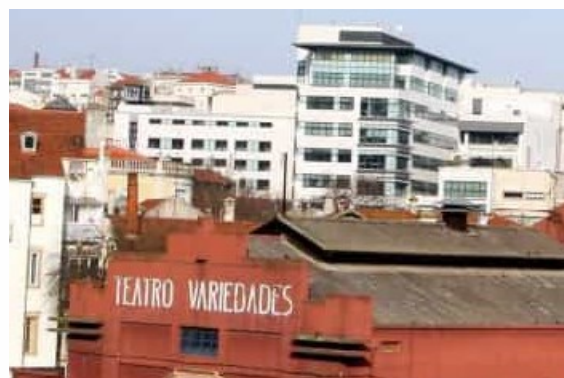
Figura 13 - Patologia na cobertura Fonte: RUIN'ART
