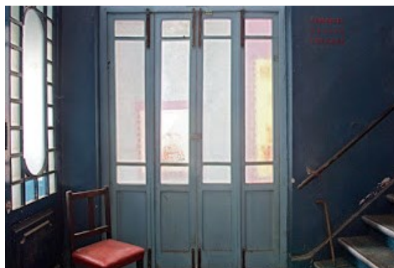
Figura 25 - Patologia nas portas Fonte: RUIN'ART
