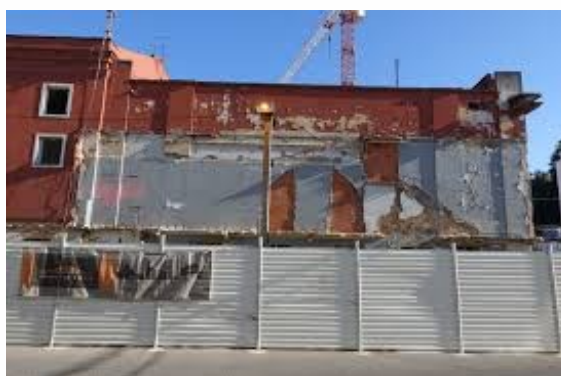
Figura 11 - Patologia nas paredes exteriores zona lateral esquerda Fonte: RUIN'ART
