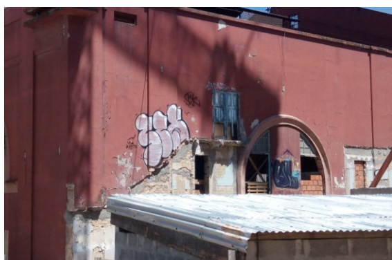
Figura 10 - Patologia nas paredes exteriores na zona lateral direita Fonte: RUIN'ART
