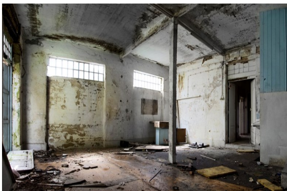
Figura 16 - Patologia nos tetos Fonte: RUIN'ART
