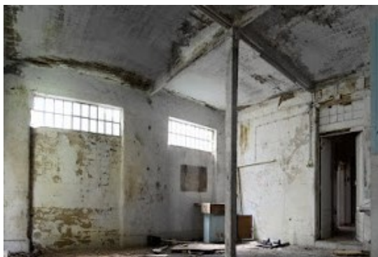
Figura 20 - Patologia nas paredes interiores Fonte: RUIN'ART
