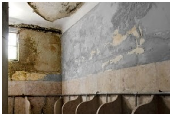
Figura 19 - Patologia nos tetos Fonte: RUIN'ART
