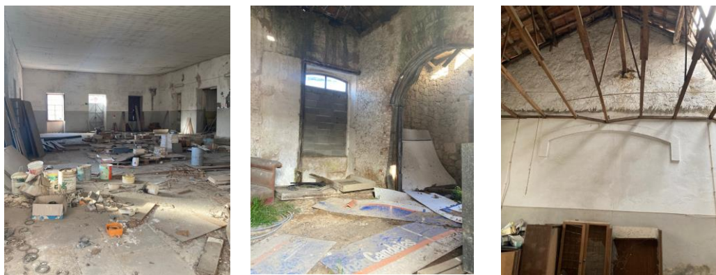
Figura 15 - Interior do antigo lagar de azeite e estrutura de madeira existente (fotografias de autor)
