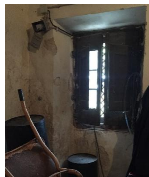
Figura 5 - Fotografia da janela do rés do chão.
