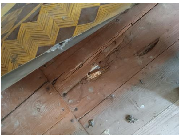
Figura 25 - Fotografia de patologias do Edifício, Desgaste do pavimento
