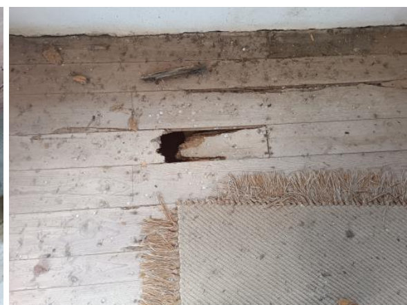
Figura 26 - Fotografia de patologias do Edifício, Desgaste do pavimento
