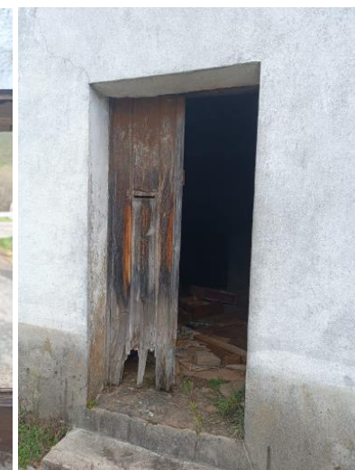
Figura 24 - Fotografia de patologias do Edifício, Desgaste
