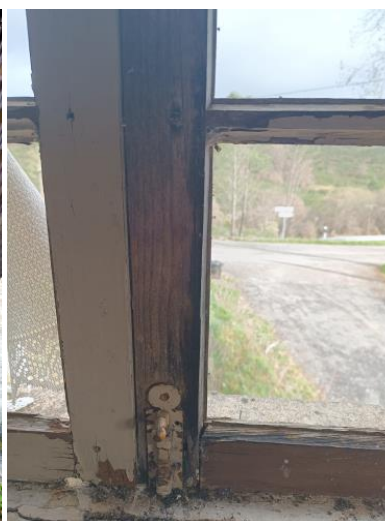
Figura 23 - Fotografia de patologias do Edifício, Desgaste
