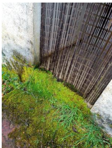
Figura 22 - Fotografia de patologias do Edifício, Humidade
