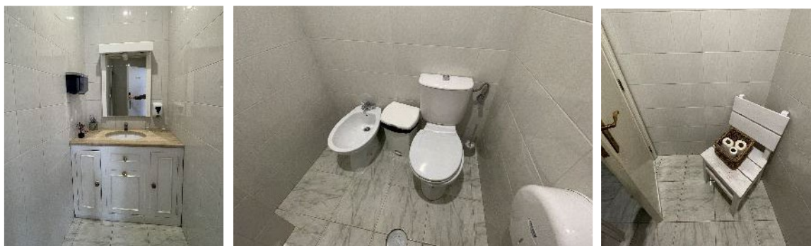
Figura 18 - Instalação sanitária de serviço feminina. Fotografia: Autora, 2025
