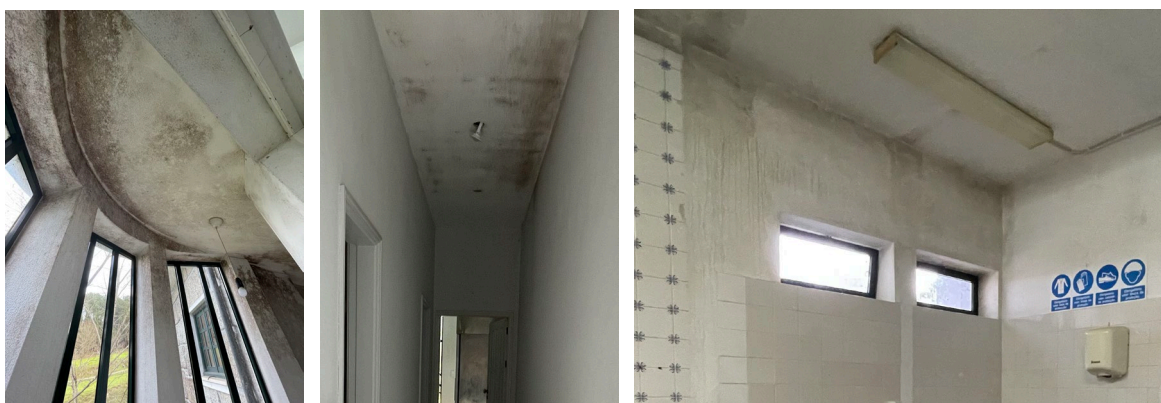
Figura 54 - Manchas de Humidade em diferentes zonas do hotel. Fotografia: Autora, 2025
