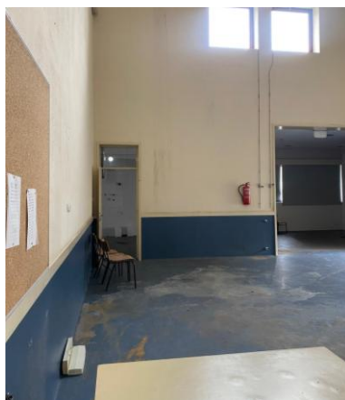
Figura 32- Piso Degradado Fonte: Autor
