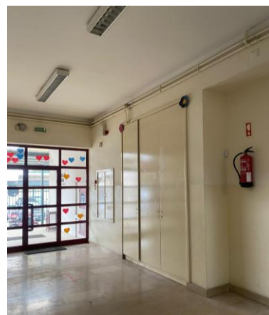
Figura 33- Quadro elétrico e arrumos Fonte: Autor
