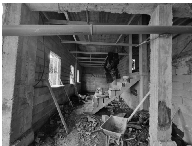
Figura 41 - Escadas na zona de passagem para as instalações sanitárias. Fonte: o Autor
