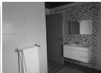
Figura 15 - Instalação Sanitária na Casa das Nações. Fonte: GCAD
