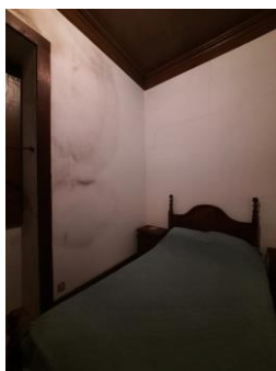
Figura 48 - Exemplo de humidade, Fonte: Autor
