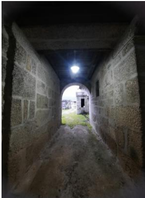
Figura 10 - Casa do Outeiro, túnel de acesso às adegas e ao exterior, Fonte: Autor
