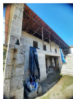
Figura 51 - Varanda do piso 1 sem proteção, Fonte: Autor
