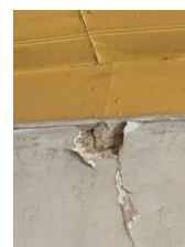
Figura 28 - Pedacos da parede a cair Fonte:Autor
