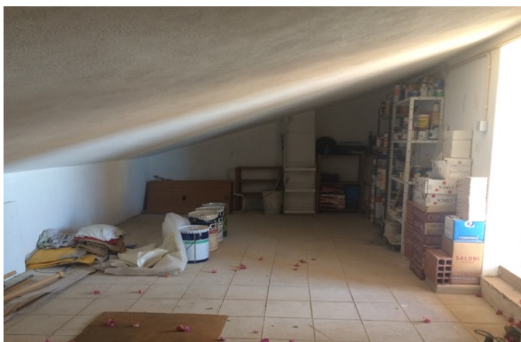
Fig. 39 - Zona de Arrumos com altura insuficiente;
