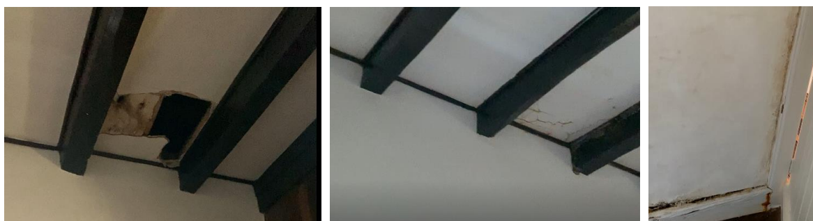
Figura 34 – Piso 0, zona de estar, degradação e patologias devido a infiltrações de água e humidades, ano de 2021.
