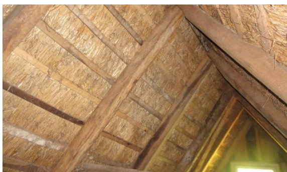
Figura 48 – Piso 2 sótão, ano de 2021.
