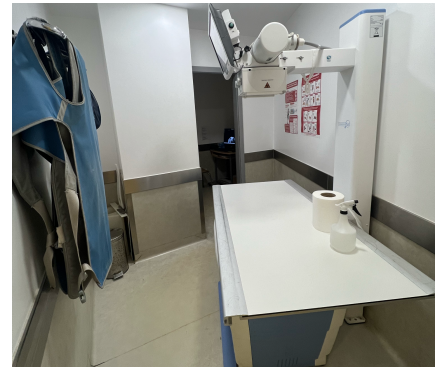
Fig. 10 - Sala de Radiologia convencional
