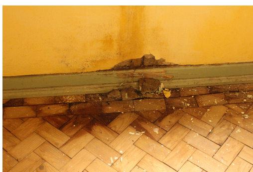
Figura 12 — Infiltrações de água que ocorrem devido às caixilharias;
