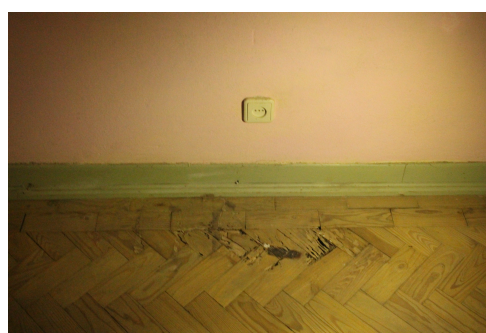
Figura 13 — Deterioração do chão de madeira ;
