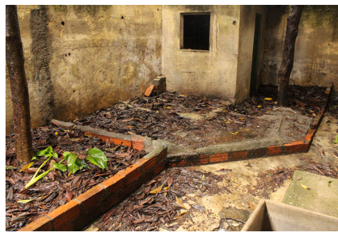
Figura 15 — Pavimento esburacado, não nivelado;
