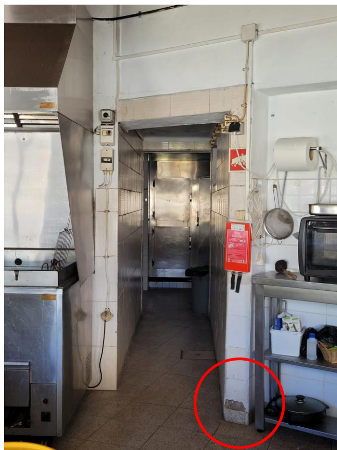
Figura 4 - Registo fotográfico de mosaicos cerâmicos partidos na área da cozinha, do autor.
