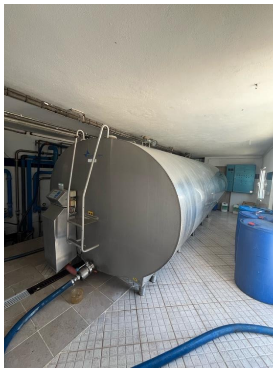
Figura 4: Tanque de refrigeração
