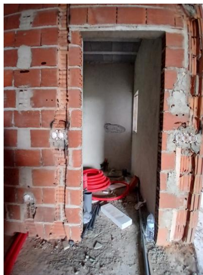
Figura 15 - Instalação sanitária comum, Fonte: Autora (2026)
