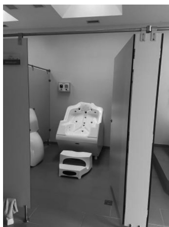
Figura 10- Sala de Tratamento Bertholaix, Fonte: O Autor
