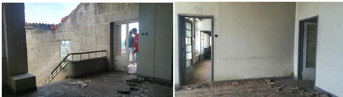
Figura 4 e 5: Fotografias espaço atual depois do incêndio; Fonte Sandra Justo;
