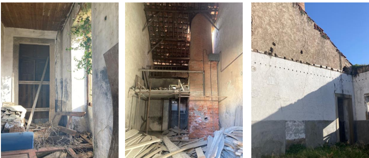
Figura 18 - Quarto anterior à chaminé; Chaminé; Interior do espaço com telhado abatido
