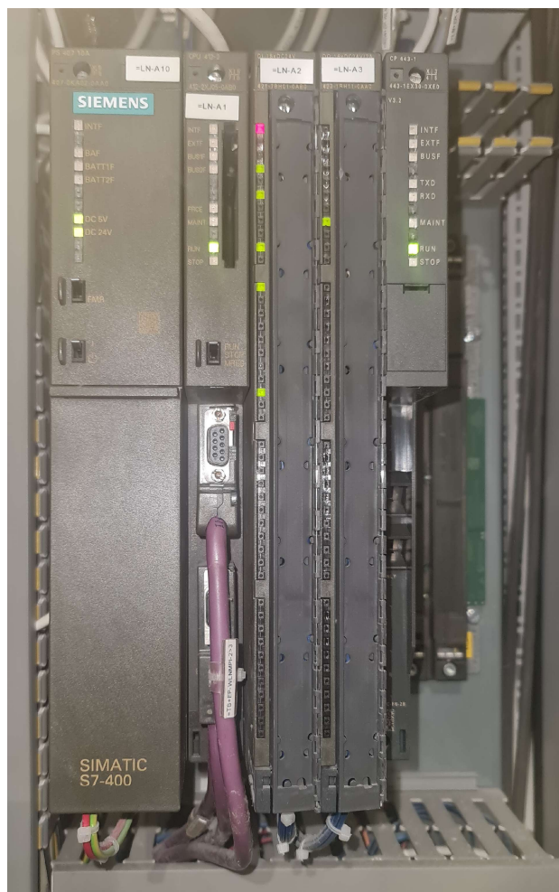
Figura 17 – Fotografia do PLC principal da linha Doméstica 2
