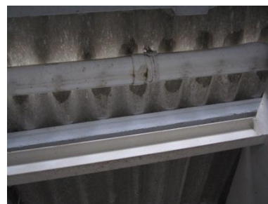
Figura 3: Degradação da cobertura central existente. Fotografia de autor.
