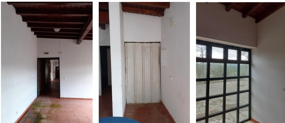
Figura 13, 14 e 15 - Interior do Bar. Como podemos ver nestas imagens as entradas estão vandalizadas e foi necessária a colocação de chapas de alumínio para controlar a entrada. Apesar destes problemas conseguimos encontrar um edifício com uma boa estrutura, e com bons materiais. Os tetos de madeira, janelas e chão encontram-se em bom estado. Fonte: Autor.
