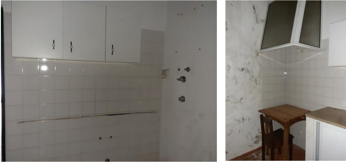
Figura 16 e 17 - Zona de Arrumos. Esta zona foi transformada numa zona de cozinha, para suporte ao bar já depois das plantas serem aprovadas pela câmara. Aqui podemos notar a falta de armários provavelmente roubados, e o mal trato das paredes, com tinta a cair devido às infiltrações da parede de pedra. Fonte: Autor.
