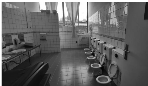
Figura 116 - Instalações sanitárias (Fonte: O Autor)
