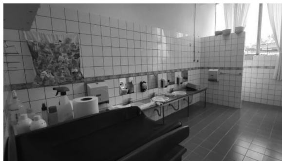
Figura 117 - Instalações sanitárias (Fonte: O Autor)
