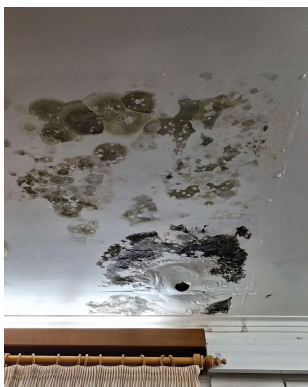
Figura 24- Problema de humidade, (16 de novembro de 2025, Autora)
