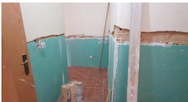
Figura 71: criação de caixa de ar com material hidrófugo, Fonte: Homify, consultado a 14 /03 2023
