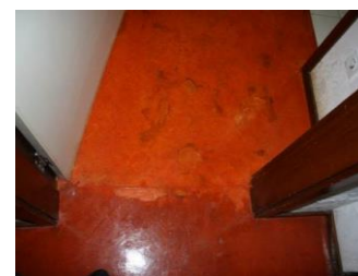
Figura 20- Degradação do pavimento vinílico
