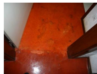
Figura 47- Degradação do pavimento vinílico
