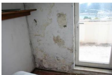
Figura 45- Humidade no interior dos quartos
