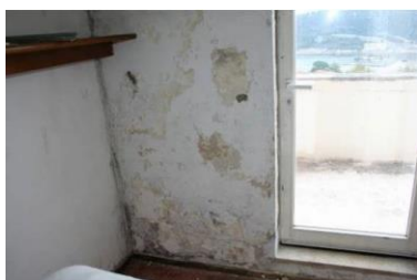
Figura 18- Humidade no interior dos quartos
