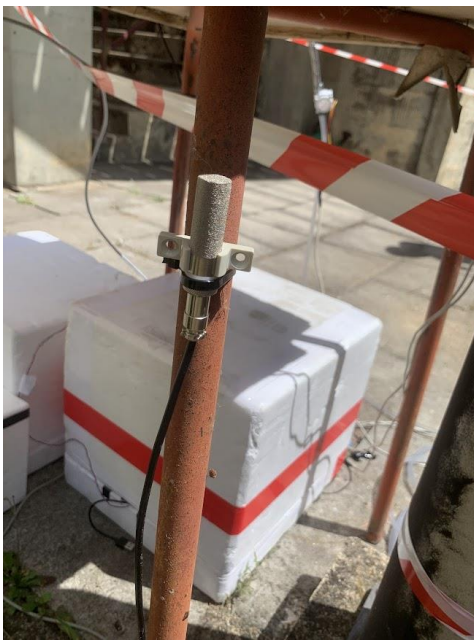
Figura 36 - Implementação Sensor de Temperatura e Humidade
