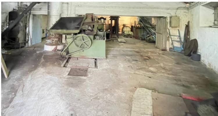
Figura 22 - Imagem com foco nas patologias do espaço: o desgaste do pavimento e a humidade das paredes. (3 de novembro de 2024. Fonte: Autora)
