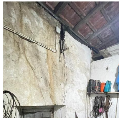
Figura 23 - Imagem com foco nas patologias do espaço. (3 de novembro de 2024. Fonte: Autora)
