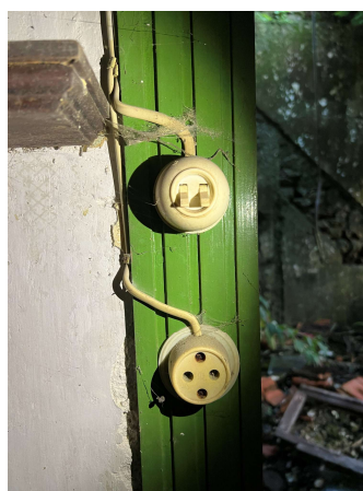
Figura 21- Pormenor de tomadas e interruptores. Pereira (2026).
