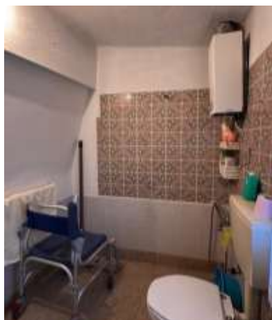
Figura 4- Instalação Sanitária da Habitação (Fonte: Autora, 2026)
