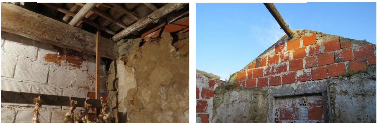
Figura 12 - (a) Telhado com vigas; (b) Telhado que ruiu.
