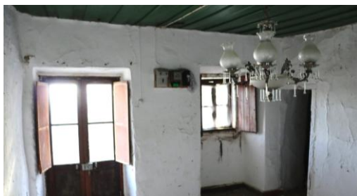
Figura 18- Zona de Entrada/ Sala 2ª Edificação. Fonte: Gil, P.(27 de outubro de 2024)
