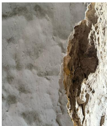
Figura 103-2 a Edificação, degradação da parede. Fonte: Gil, P. (27 de outubro de 2024).
