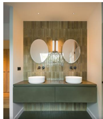
Figura 81- Instalação Sanitaria. Fonte: François Dantart, (2024).
