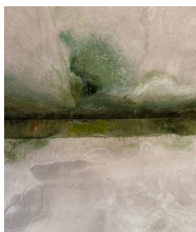
Figura 99-1ª Edificação, Infiltração e Fissura. Fonte: Gil, P. (27 de outubro de 2024).
