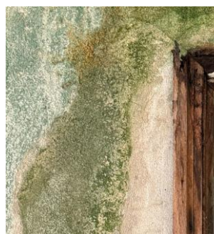
Figura 100-1ª Edificação, Degradação das Madeiras. Fonte: Gil, P. (27 de outubro de 2024).
