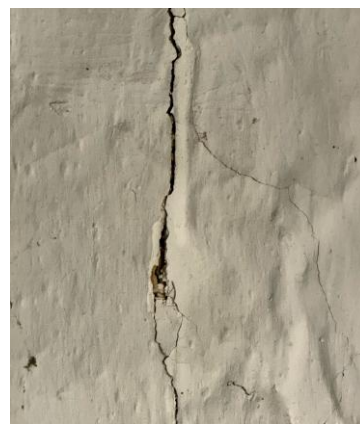
Figura 104-2 a Edificação, identificação de fissura. Fonte: Gil, P. (27 de outubro de 2024).
