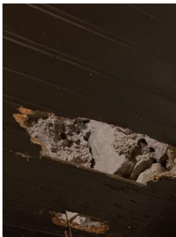
Figura 106-2ª Edificação, Forro de madeira em condições de degradação. Fonte: Gil, P. (27 de outubro de 2024).
