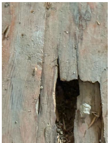
Figura 105-2ª Edificação, Pavimento de madeira em estado de degradação. Fonte: Gil, P. (27 de outubro de 2024).
