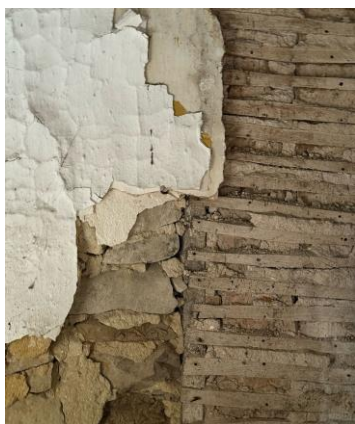
Figura 102- 2. a Edificação, deslocamento do revestimento. Fonte: Gil, P. (27 de outubro de 2024).
