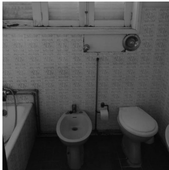
Figura 21 – Instalação Sanitária Piso 1. Fonte: Autor.
