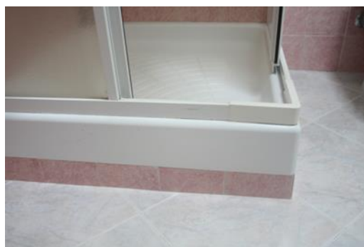
Figura 14- Poliban da suite do casal. O degrau para a entrada/saída para o poliban é alto para o utilizador, sendo perigoso. (Fotografia de Ana Reis)
