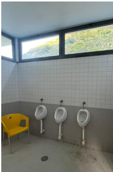
Figura 36- Urinóis em frente às casas de banho privadas
