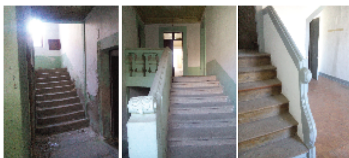
Figura 8: Escadas principais, degraus e corrimãos em pedra de granito; Escadas de acesso ao sótão, degraus em madeira e corrimãos em pedra de granito;
