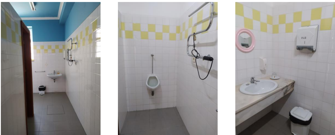
Figura 12, 13 e 14 – Instalações sanitárias
