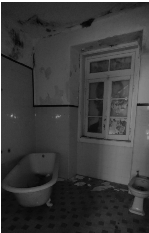
Figura 18 - Paredes com humidade e desgaste | Beatriz Figueiredo
