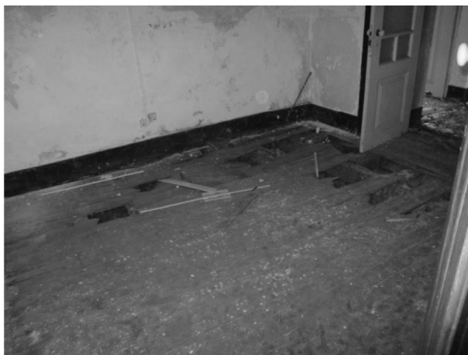
Figura 17 - Pavimento em estado degradado | Beatriz Figueiredo
